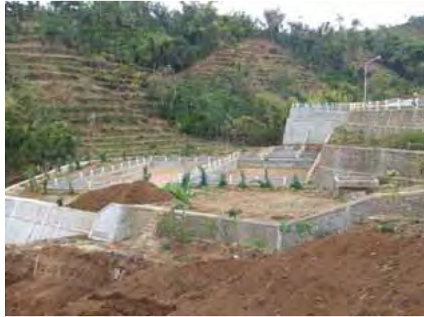
図 2 - 2 - 12 バツ－処分場水処理施設
