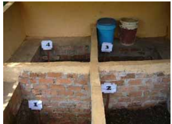
中学校に設置されたコンポスト化施設
