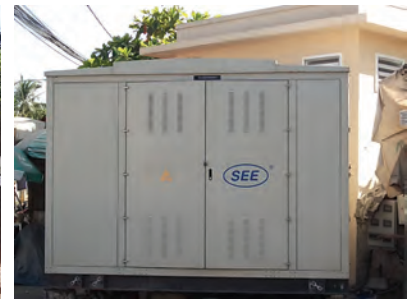
c. プレハブ式変電所
