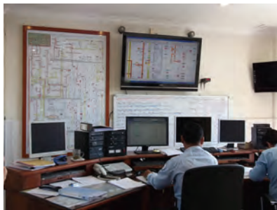
a. EDC 'SCADA
