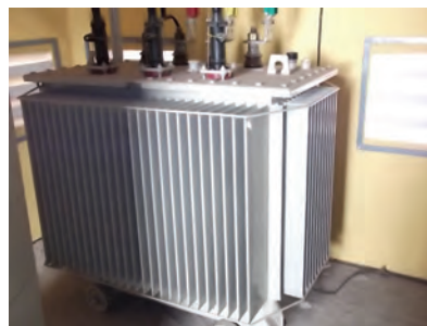
e. 建屋式変電所
