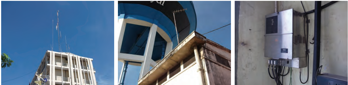
(a) EDC 屋上 UHF アンテナ
