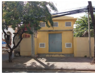
b. 建屋式変電所
