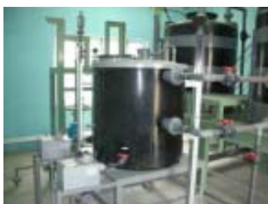
ゴウラダ塩素設備
