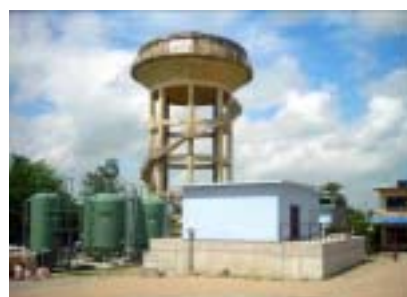
マンガドゥ除鉄装置全景
