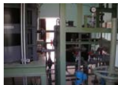
マンガドゥ塩素設備
