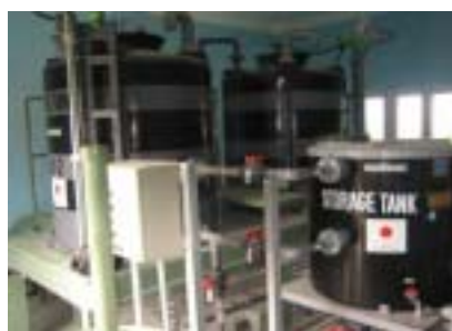
ドゥラバリ浄水場塩素設備
