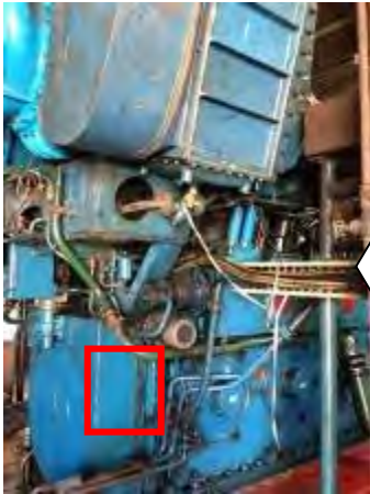
現地のディーゼル発電機 (No.1 発電所第 2 号機、 出力 2.5MW、Peilstick 製)
