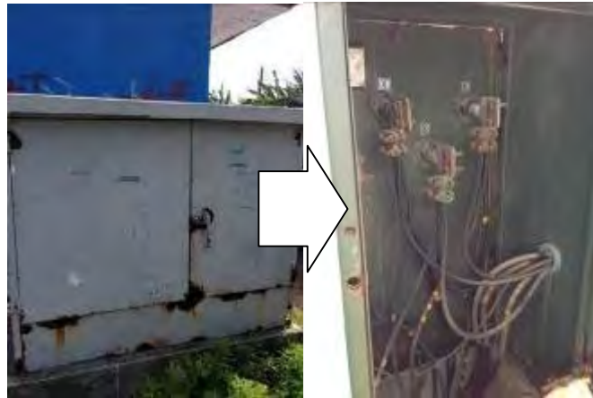
現地の変圧器
