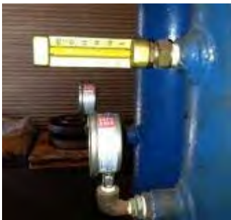
現地のディーゼル発電機 計器（温度計）故障 ほかにも多数故障計器あり
