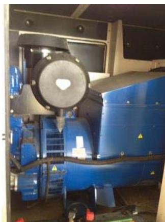
写真 K：CBM ヤンゴン。停電に備えた自家発電装置。
