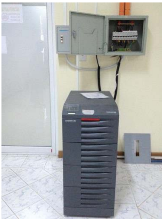
写真 I：CBM ネピドー本店のサーバーーム。停電に備えた大型 UPS。
