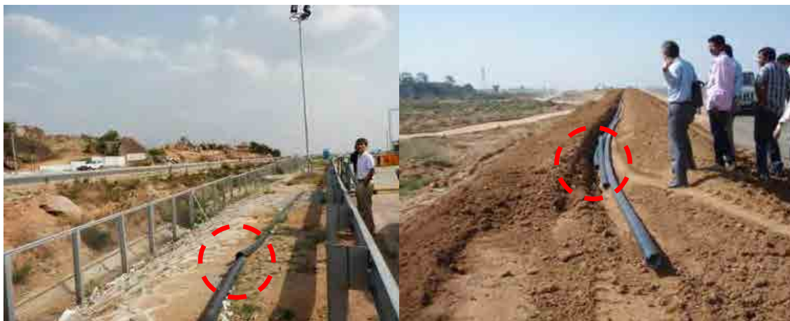
埋設されておらず接続されていない管路
