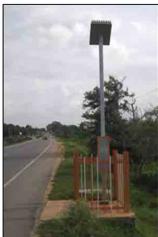
写真 5.2：非常電話装置
