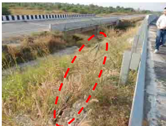
不適切に設置された管路
