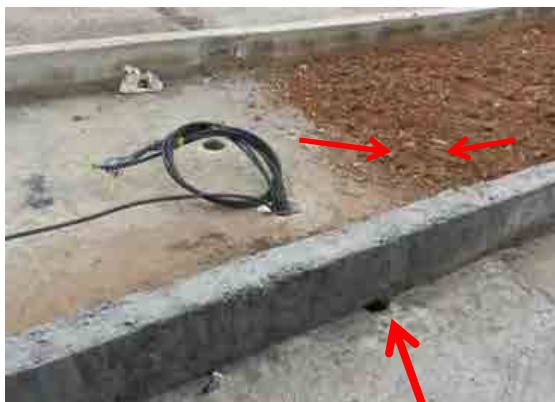
アイランドの外側にあるケーブルダクト
