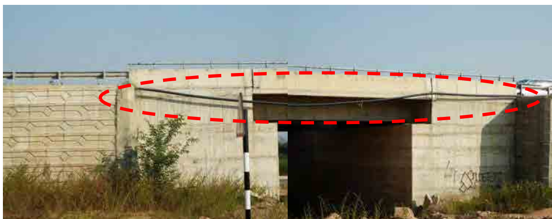
擁壁に固定されておらずぶら下がった状態の管路
