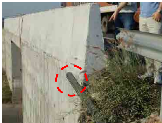
不適切に設置された管路
