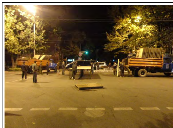
Установка оборудования ночью перед началом мероприятия
