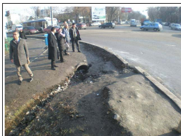
Разрушенная дренажная система и «оборванный» пешеходный тротуар
