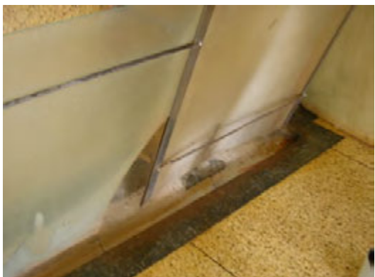
既存手術棟内部：老朽化や破損が著しく、衛生環境の面でも良いとは言い難い。
