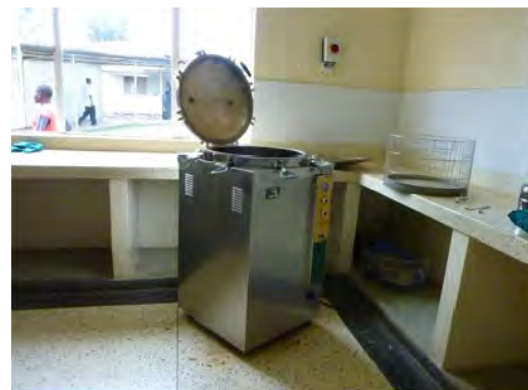
手術棟の材料滅菌室に設置された高圧蒸気滅菌器
