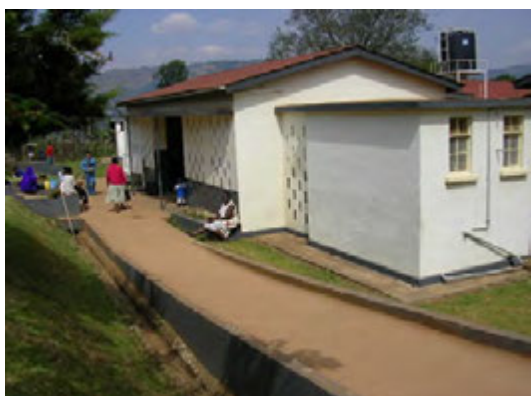
老朽化した既存外来診療棟:本計画の外来・救急棟が完成後に解体され、駐車場・前庭になる予定。
