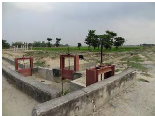
02 幹線末端の分水工 第2次水路 Kankai 灌漑プロジェクト コンクリート構造物(Jhapa)
