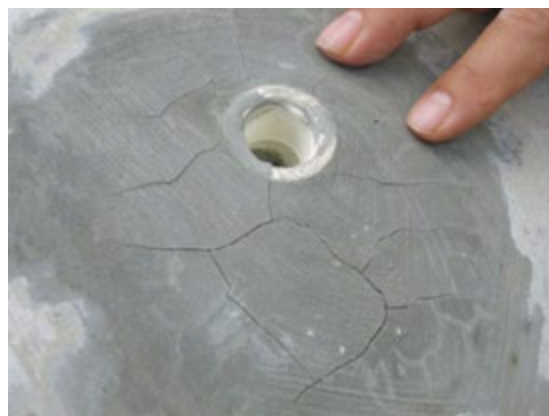
写真 10-8 蛇口取り付け部と周囲のクラック (サテライト工場)
