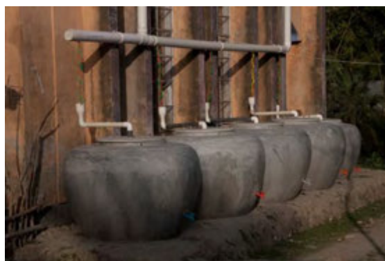
写真 9-20 モスクに設置されたタンク
