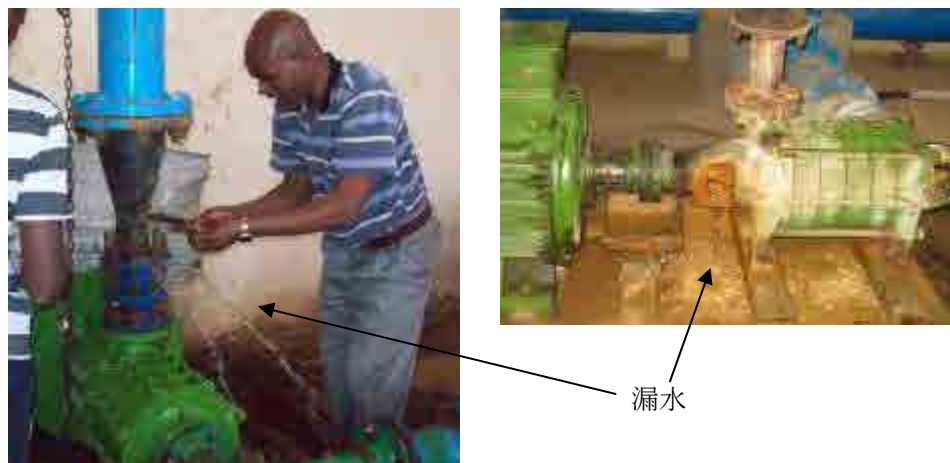
図 2.9: 送水ポンプからの漏水の状況 ポンプ交換時(左)と常時漏水(右)
