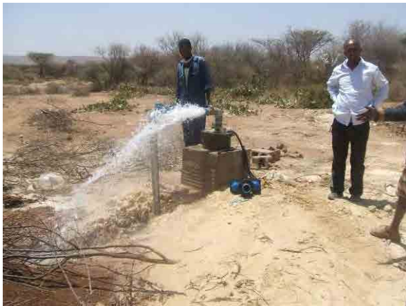
パイロットプロジェクトで設置した井戸利用 パイロットプロジェクトで掘削した井戸を利用する前に Kabri beyah 市までの配管の通水試験が実施された。
