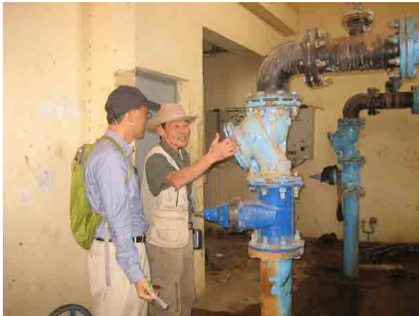
Kabribeyah 給水施設
