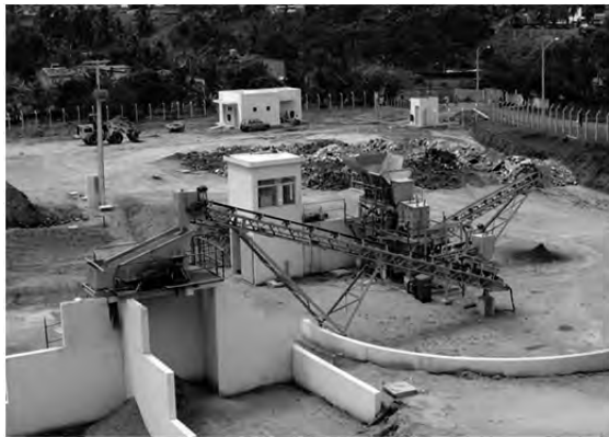
(4) Planta fija para reciclaje de escombros
