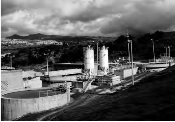
Planta de Tratamiento de Líquidos Percolados
