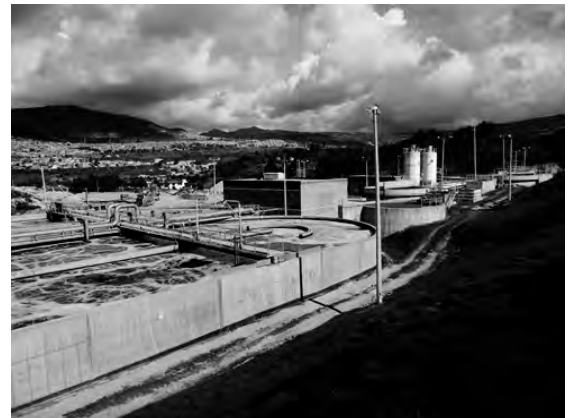
Planta de Tratamiento de Líquidos Percolados
