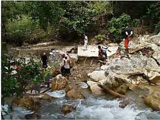
photo-1: Visaun hotu konaba fasilidades Intake ho pipa transmisaun nian.
