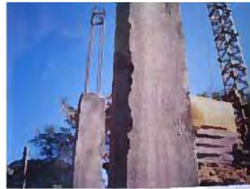
Lackof corner/kekurangan sudut
