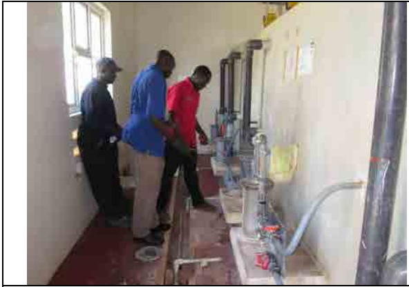
塩素注入機の設置
