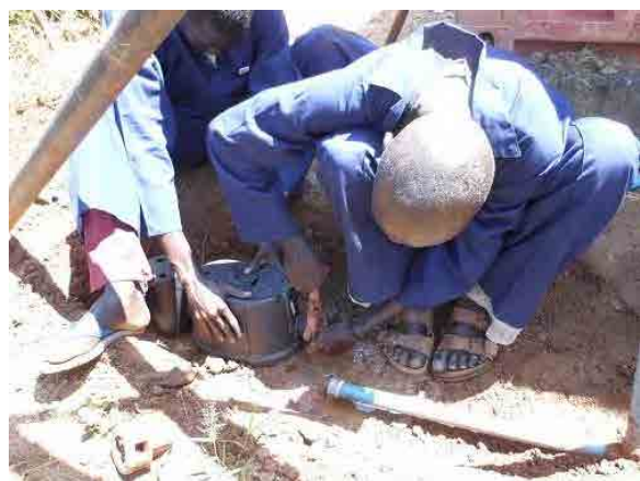
顧客メータ設置 (テストメータフィールド)
