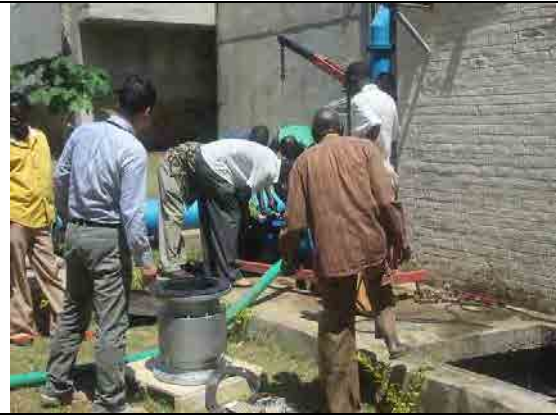
電磁流量計の設置
