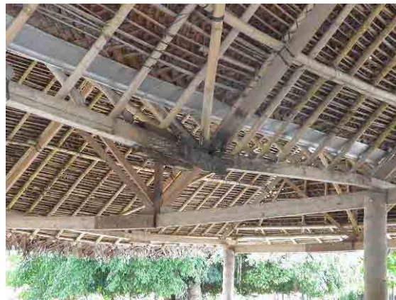
マダン市場の既存市場棟の現況③： 構造体の激しい損傷も見られる。
