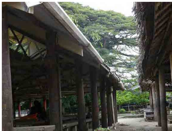
マダン市場の既存市場棟の現況①： 雨樋の損壊等の老朽化が見られる。
