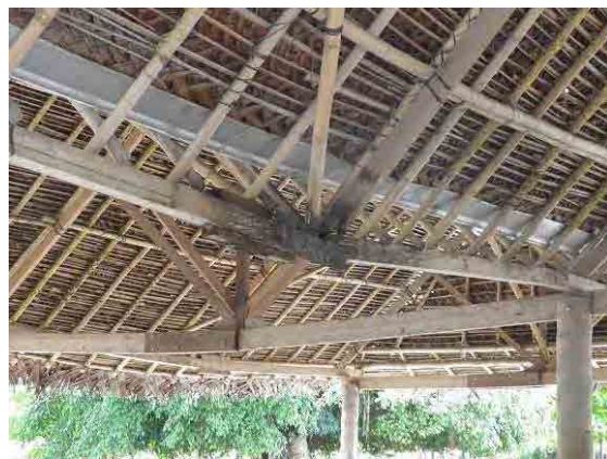
マダン市場の既存市場棟の現況③： 構造体の激しい損傷も見られる。
