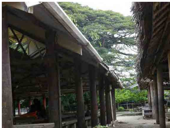
マダン市場の既存市場棟の現況①： 雨樋の損壊等の老朽化が見られる。
