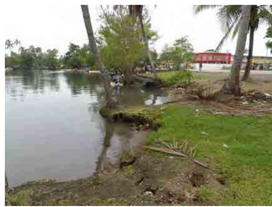
ラグーン岸部の状況： 既存護岸の老朽化（崩壊）が進んでいる。
