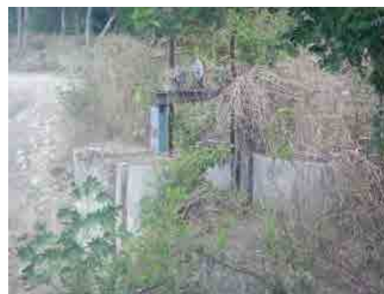
写真-5 旧取水工地点の放流ゲート跡 頭首工建設予定地点の右岸に放置されている、崩壊したままの放流ゲート跡。
