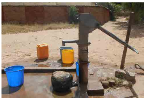
アフリデブハンドポンプ付深井戸給水施設 (ムチンジ県、5月16日)
