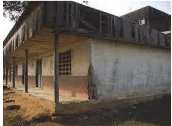
建物の躯体は比較的しっかりしているが、壁の崩壊や浸食がひどい状況。(アボボ・コミュニン)
