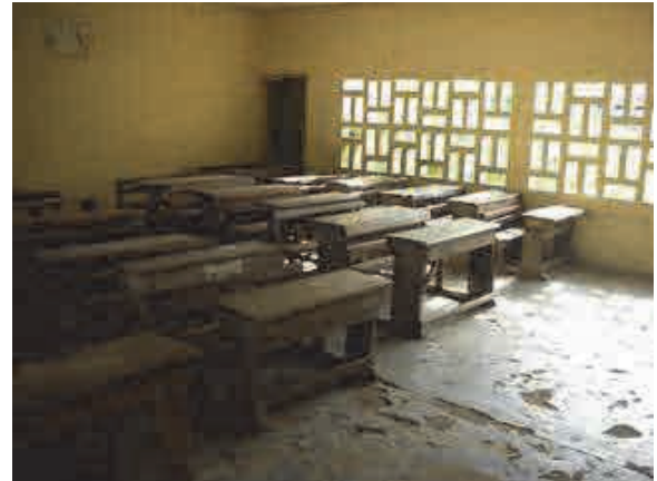
教室内の状況。雨漏りがひどく、床のコンクリートが剥けている。(アボボ・コミュニン)
