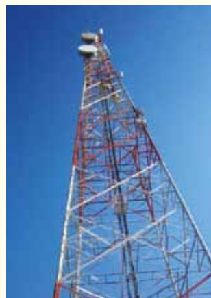
ヤンゴン市内の通信タワー
