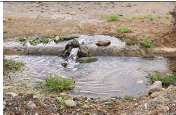
写真-42. 石綿管からの大量の漏水
