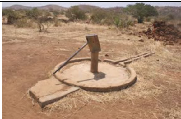
写真-50. 故障したハンドポンプ
