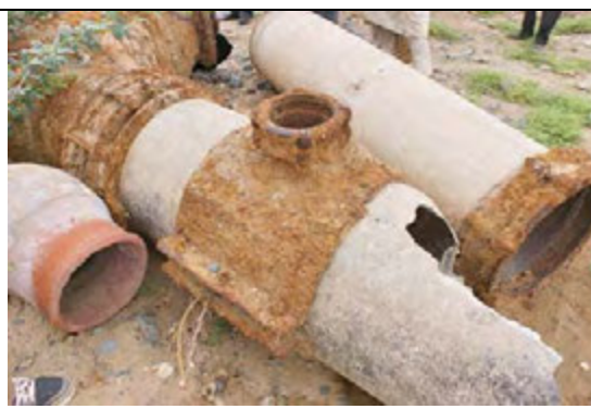
写真-45. 劣化したバルブ
