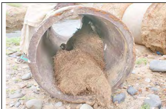
写真-44. 植物根のパイプへの侵入 (内部)
