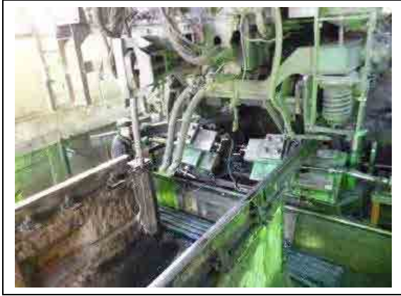
【図 2-32】 在姿旋盤の床下の状況
