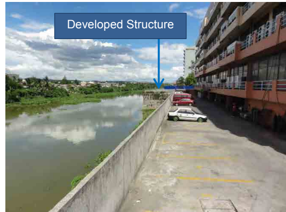
駐車場は、10 m 以上、川側へせり出している。
