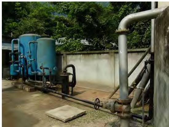
バングラデシュ水供給プログラム・プロジェクト（BWSPP）における、ケラニガンジ地区の浄水場
