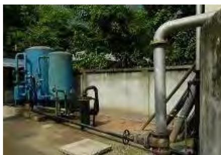
ダッカ地区のケラニガンジで実施されている BWSPP の地下水処理施設
