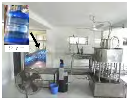
GVW の浄水場に新設されたジャーウォーター製造施設のボトル詰用機械
