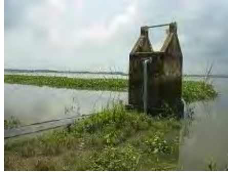
GVW の浄水場の取水塔
