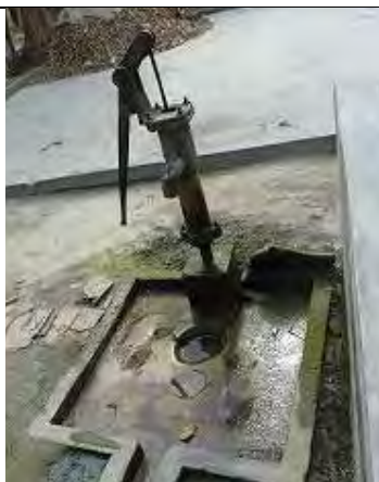
深井戸 (掘り抜き井戸)
