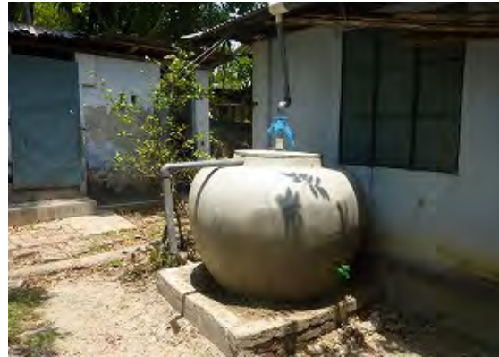
家庭における雨水タンク (AMAMIZU) の設置状況 ((株) 天水研究所による BOP ビジネス)
