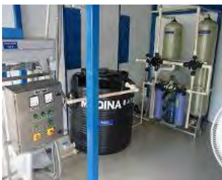
WHC 内部の水処理設備
