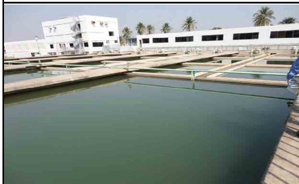
首都ビエンチャン水道公社Kaorio WTP
