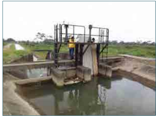
写真2-4 幹線水路水位調節ゲート （ゲート損傷、ハンドルとスピンドル紛失）
