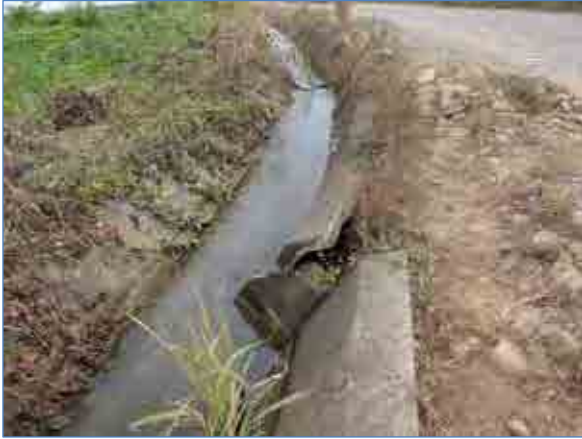
写真 2 - 7 二次水路の破損状況
