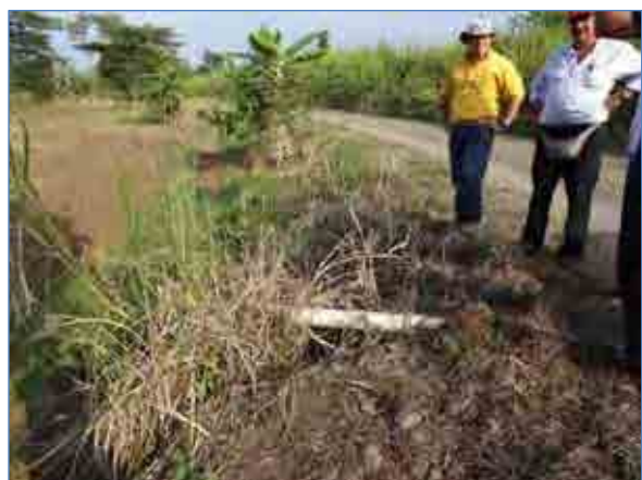
写真2-14 二次水路からの盗水パイプ
