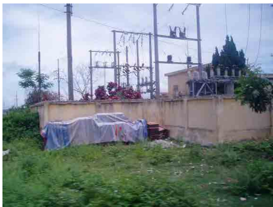
Ảnh 1 Trạm biến áp cũ ở đảo Cát Hải
