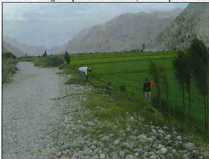
FOTO N° 50: MC-02 - Margen Izquierda Río Camaná, Dique erosionado (9+300)
