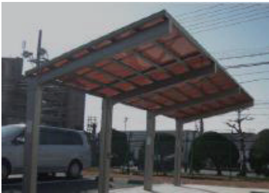
カーポートの屋根に設置したパネル
