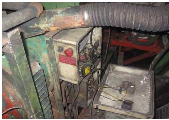
発電機 ターミナルボックスの不具合
