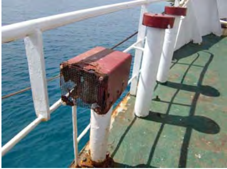
管頭部の腐食
