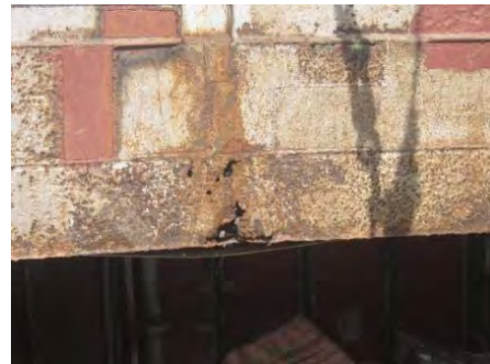
図 2-2 倉口周囲縦桁の腐食
