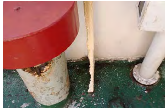
通風筒の錆が進行
