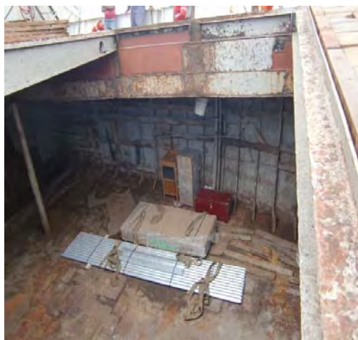
貨物艙 ハッチコーミング、ピラー、側壁鋼板の各所に錆が顕著
