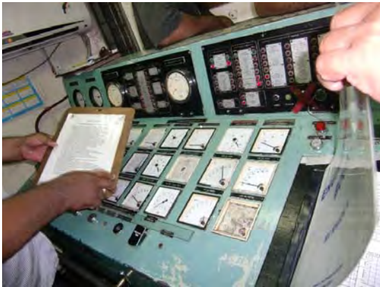
機関モニター室 各計器の不具合
