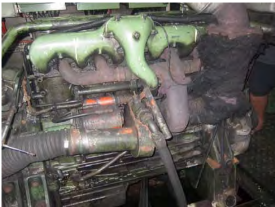
主機関 排気管防熱材の劣化
