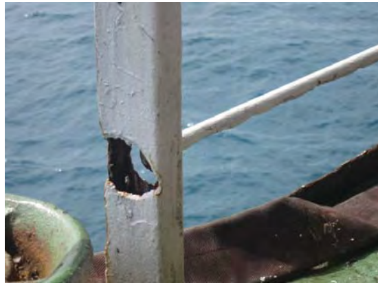
船尾甲板の手摺りを支持するスチの腐食状態
