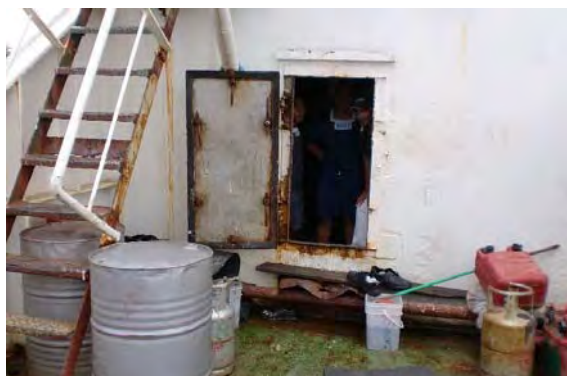
右舷貨物甲板部 水密ドアに錆、下のステップは錆落ちて木板で代用している
