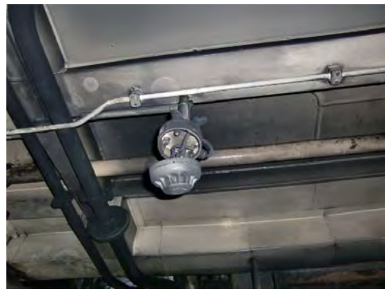
機関室 火災報知器故障
