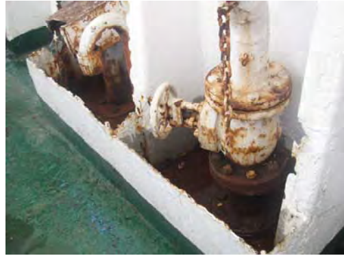
燃料給油管 燃料漏れ防止用囲い鋼板が錆びて形を成していない
