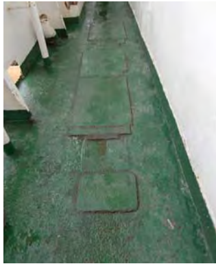
甲板通路のパッチ当て状態
