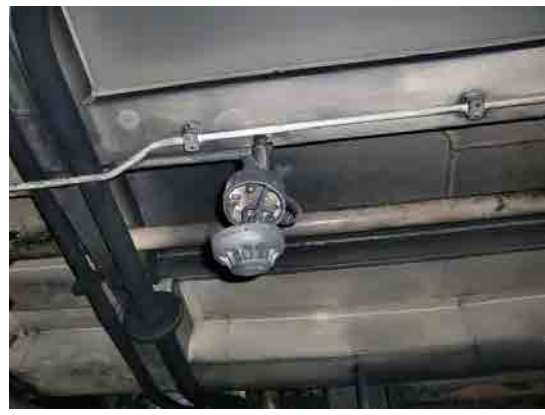
機関室 火災報知器故障
