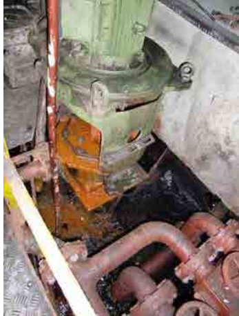
ビルジポンプが故障 (予備調査で指摘)
