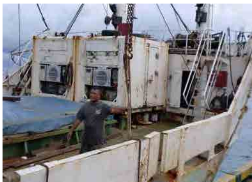
2基の冷凍コンテナの1基は故障 (予備調査で指摘、現状は2基搭載)
