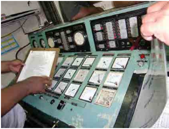
機関モニター室 各計器の不具合
