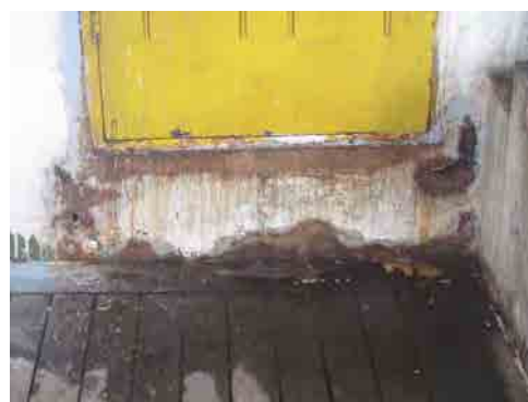
左舷貨物甲板部 トイレ入口 腐食孔が散見される
