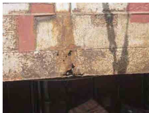
ハッチコーミング左舷側中央部の強度部材である縦桁の腐食
