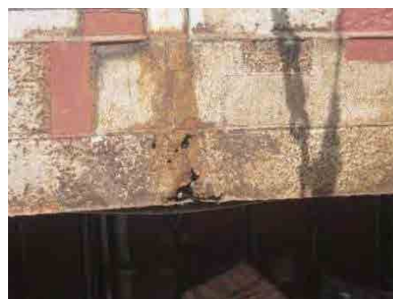
図 2-2 倉口周囲縦桁の腐食
