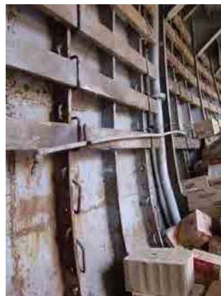
貨物艙 側壁木板の補修がされていない
