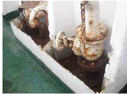
燃料給油管 燃料漏れ防止用囲い鋼板が錆びて形を成していない
