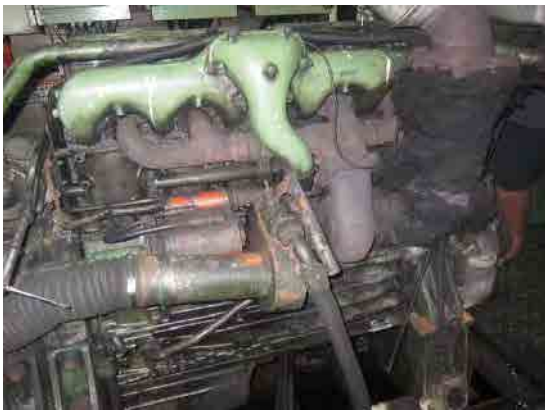
主機関 排気管防熱材の劣化
