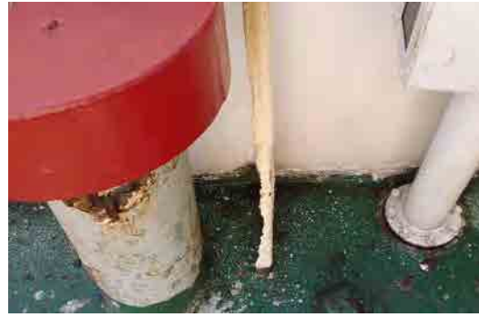
通風筒の錆が進行
