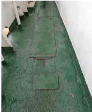
甲板通路のパッチ当て状態
