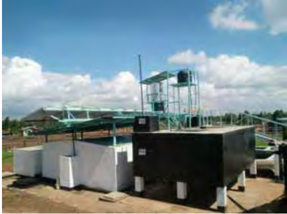
バイオガス・プラント全景
