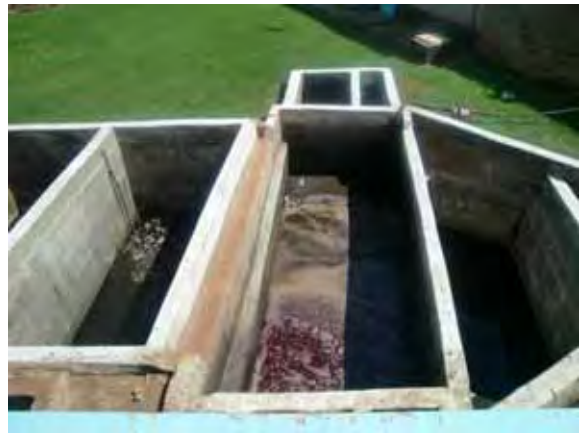
好気性処理タンク
