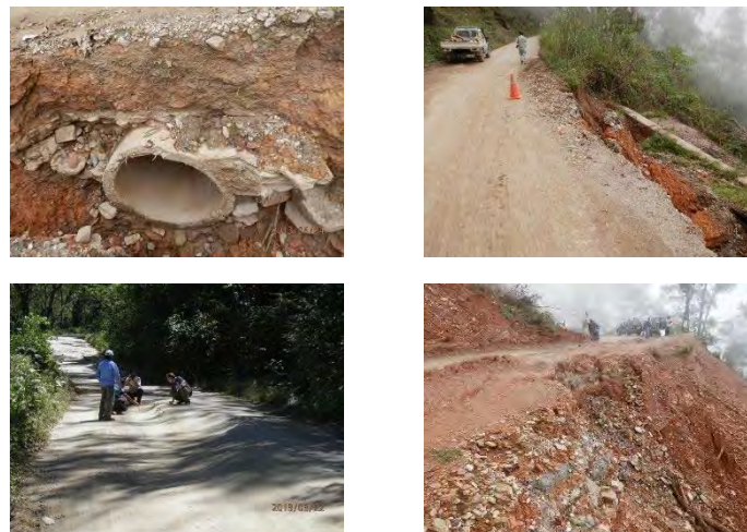
写真 破損状況
