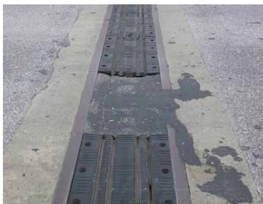
Hình 2.4-1 Trám vá tạm thời bằng Bitum
