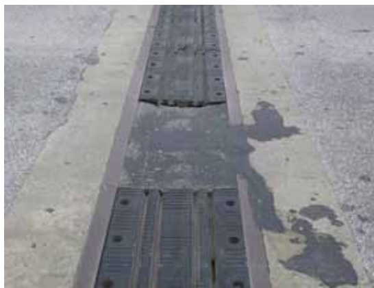
Hình 2.4-1 Trám vá tạm thời bằng Bitum
