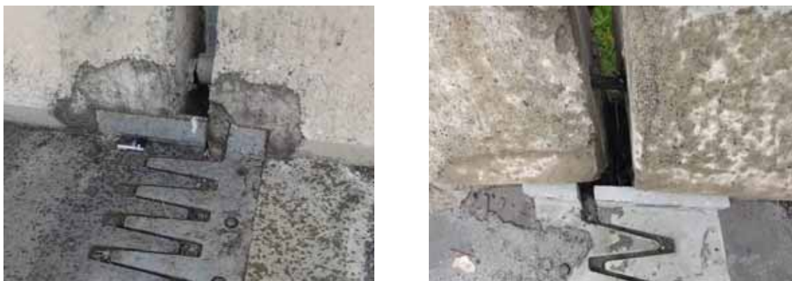
Hình 2.4-2 Cấu kiện ngăn nước không phù hợp ở hai đầu khe co giãn
