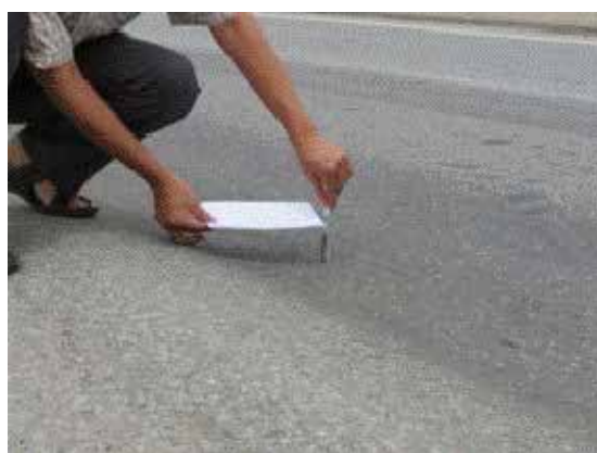
Lún vệt bánh xe do chảy của hỗn hợp asphalt
