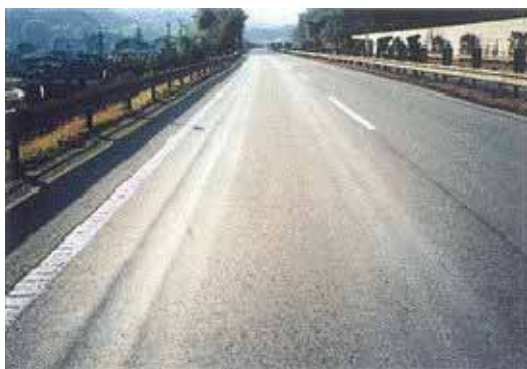
Lún vệt bánh xe do sự chảy của hỗn hợp asphalt
