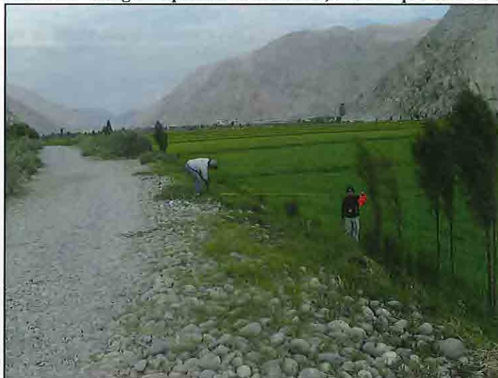
FOTO N° 50: MC-02 - Margen Izquierda Río Camaná, Dique erosionado (9+300)
