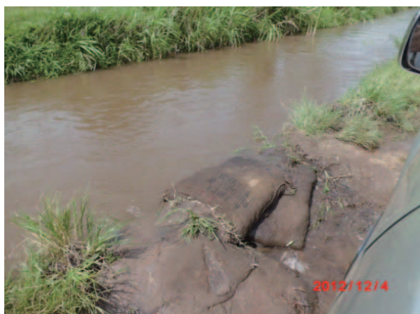
導水路溢水箇所
