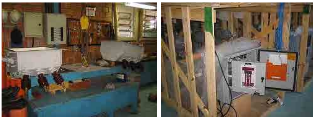
Figura 7.2-2 Instalações de Teste para Verificação dos Equipamento Instalados (LBS e RC)
