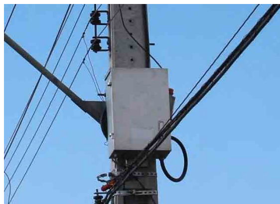
Figura 6.4-3 RTU em um poste
