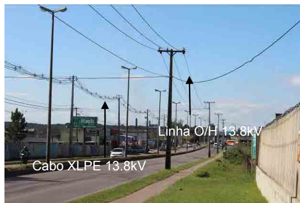
Figure 6.4-1 Linha de interconexão de 13,8 kV (Fonte: Equipe de Pesquisa JICA)
