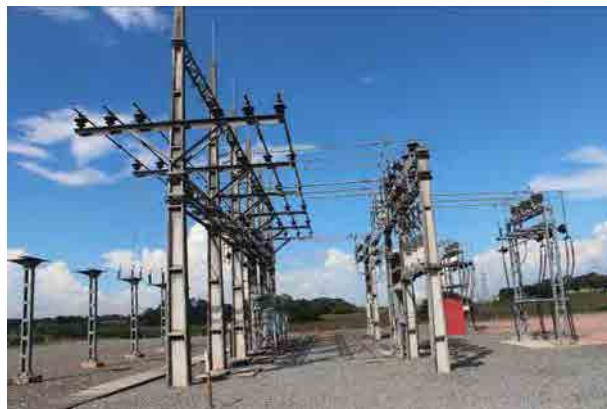
Figura 4.2-2 Fazenda Rio Grande subestação (Fonte: Foto pela Equipe de Pesquisa)
