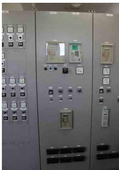
Figura 4.2-5 Painel de Controle na Subestação da Fazenda Rio Grande
