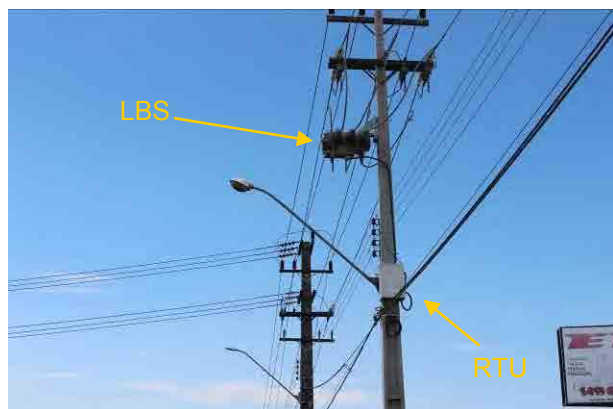
Figura 6.4-2 Instalação do LBS e da RTU
