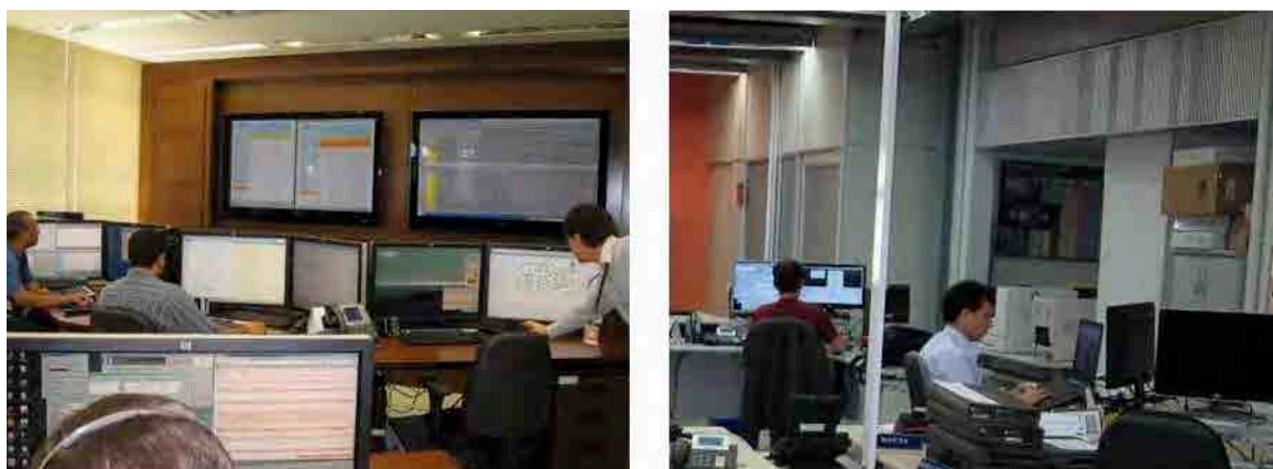
Figura 4.5-6 Centro de Telecomunicações da COPEL
