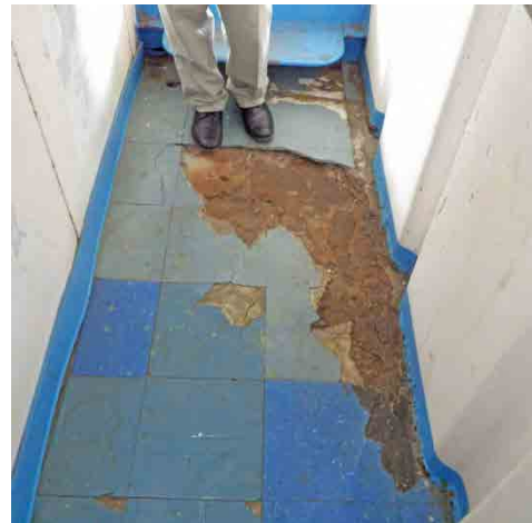
室内廊下床鋼板の腐食
