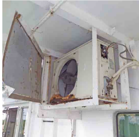
エアコン室外機の故障
