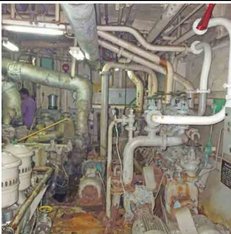
機関室内の状況、至る所に錆びが発生している。
