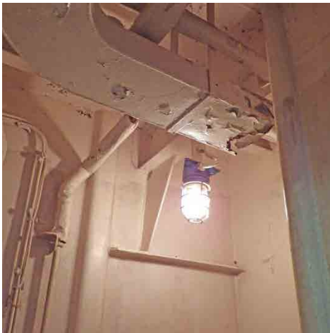
通風ダクトの腐食・ペンキ剥がれ
