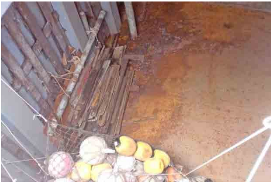
貨物倉床鋼板の錆び
