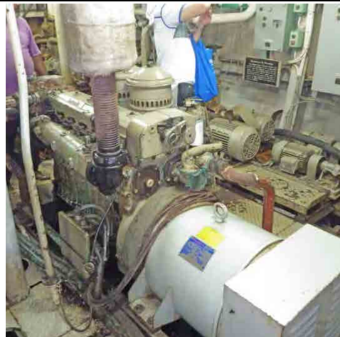
稼働している発電装置
