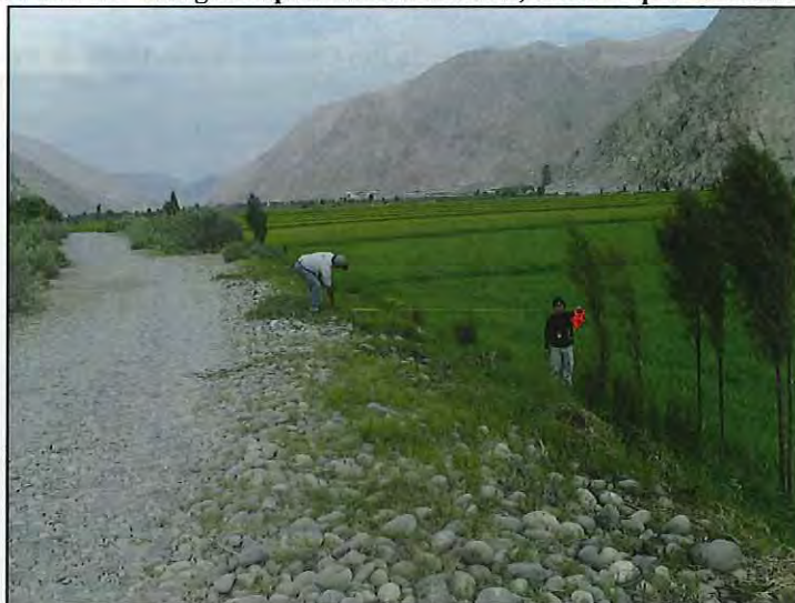
FOTO N° 50: MC-02 - Margen Izquierda Río Camaná, Dique erosionado (9+300)
