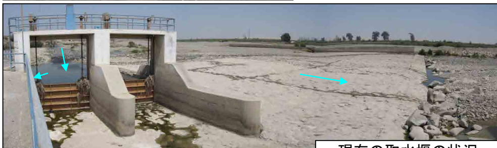
現在の取水堰の状況
