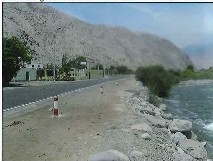
FOTO N° 15: Ca-05 - Margen Derecha Río Cañete – Zona crítica Vía Los Libertadores (26+500)
