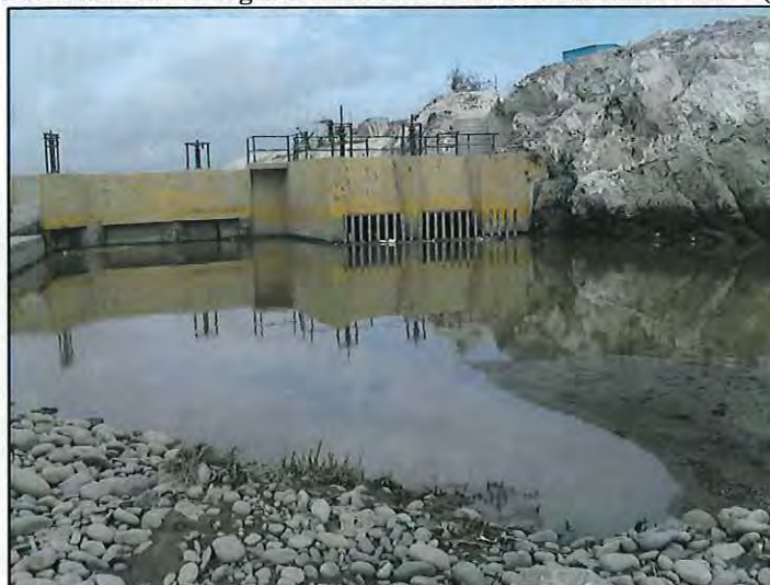
FOTO N° 36: Pi-02 - Margen Derecha Río Pisco – Bocatoma Caucato (6+740)
