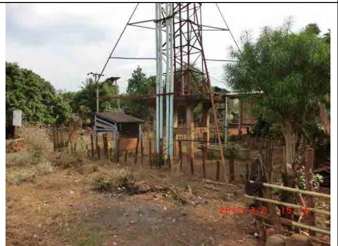
村落給水施設
