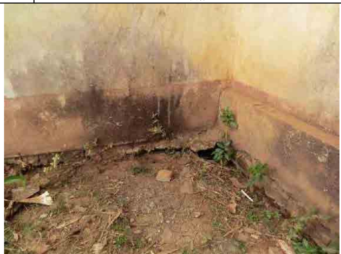
基礎部のうき
